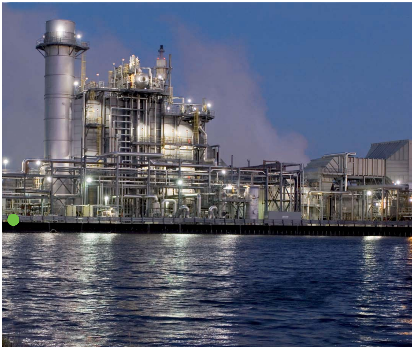
Centralele cogenerative care funcționează cu gaz au o eficiență de până la 95%
