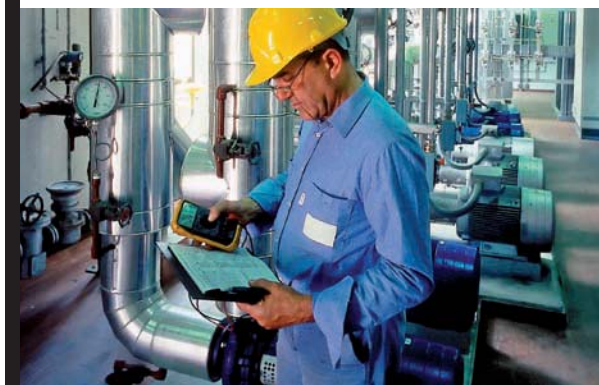
Instalatorul care are grijă de centrala cartierului ar putea deveni o prezență obișnuită în viitor
