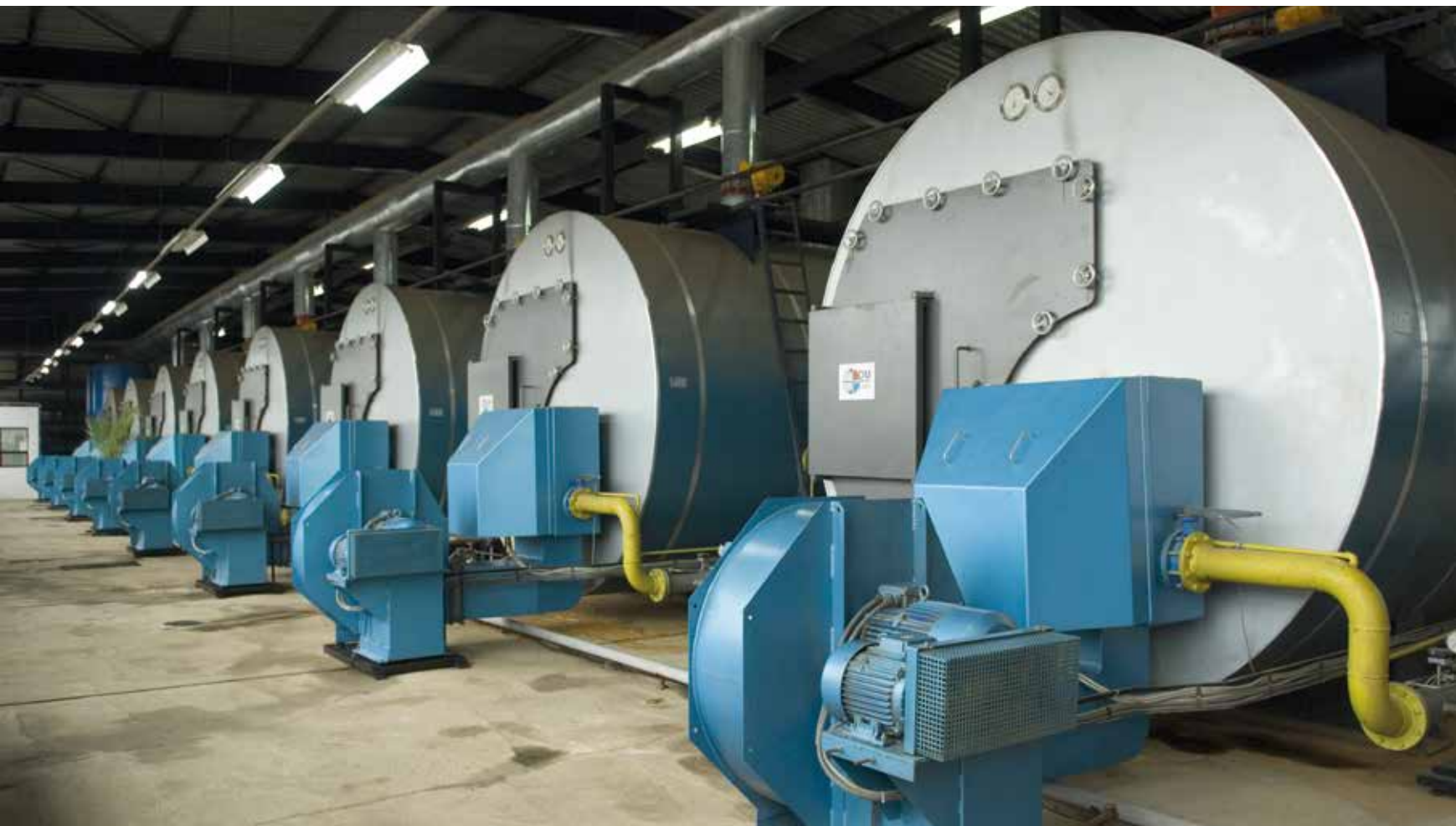
Sala boilerelor care asigură încălzirea serelor Greenhouse boiler room
